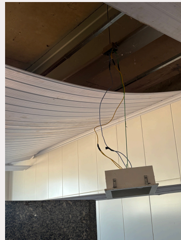
(Forro do banheiro feminino caindo)
