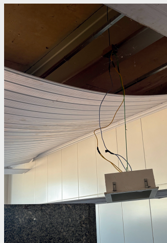
(Forro do banheiro feminino caindo)
